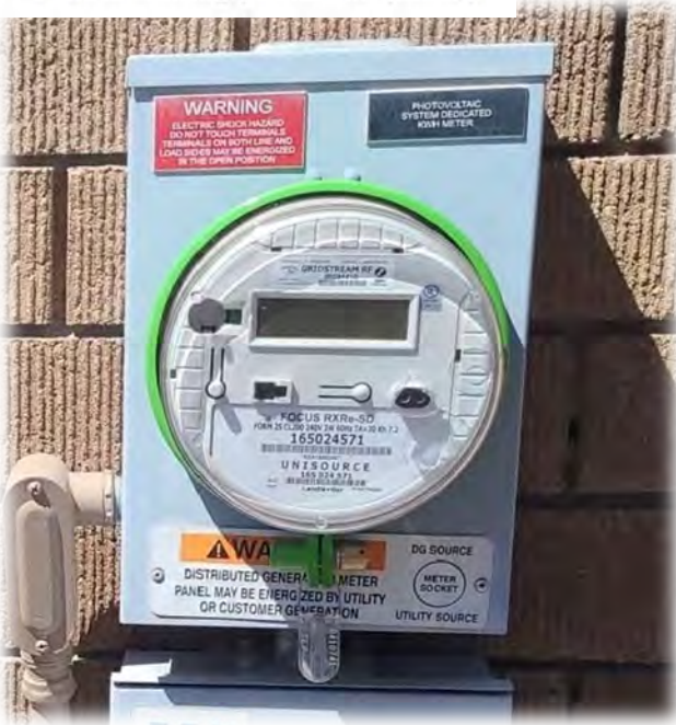
PV Meter Wiring (meter not pulled)
